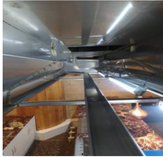
主楼负一楼厨房烟罩清洗后
