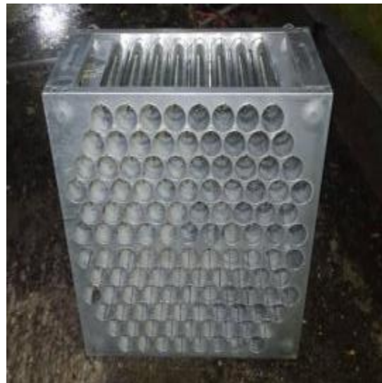
主楼负一楼厨房净化器清洗后
