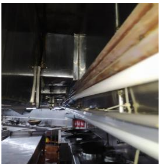
主楼3楼厨房烟罩清洗前 3
