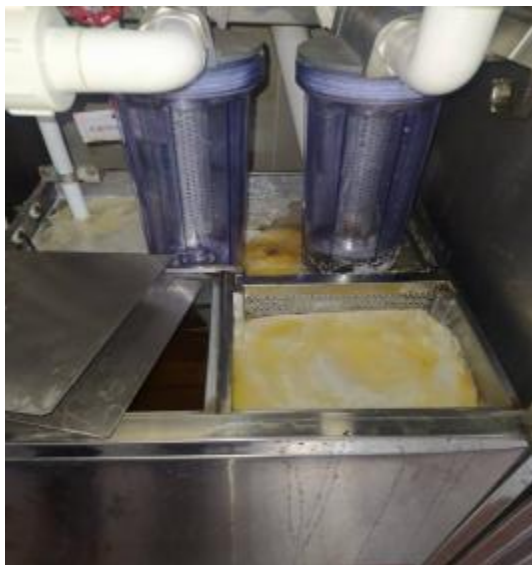
东楼 1 楼运水控制箱清洗前
