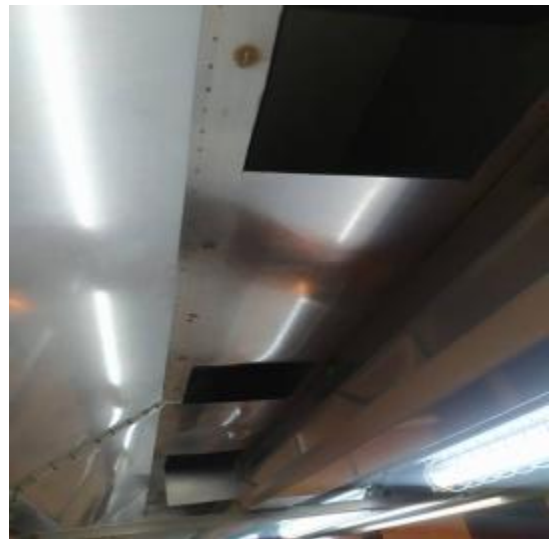
主楼1楼西厨烟罩清洗后
