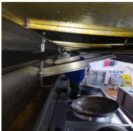
东楼 1 楼烟罩清洗前 2
