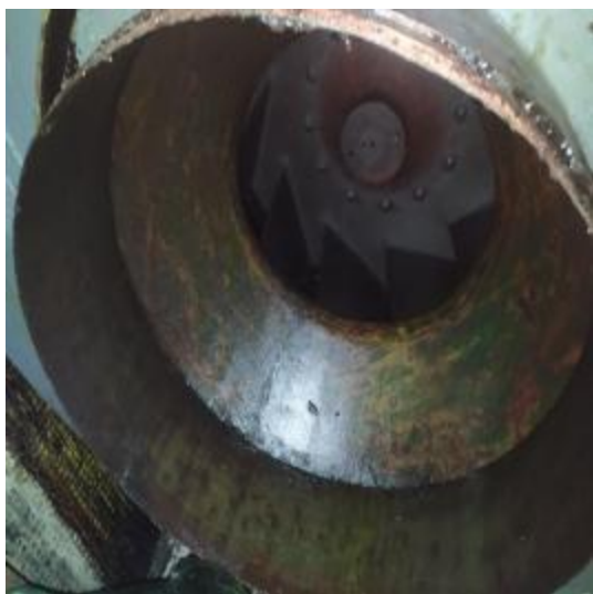
主楼平台风机清洗前 1
