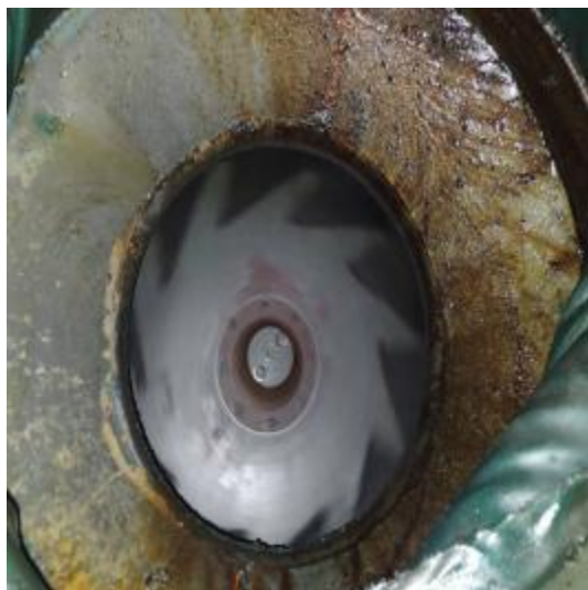
主楼平台风机清洗前 2
