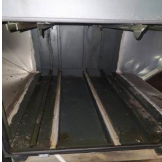
东楼1楼净化器机箱清洗后
