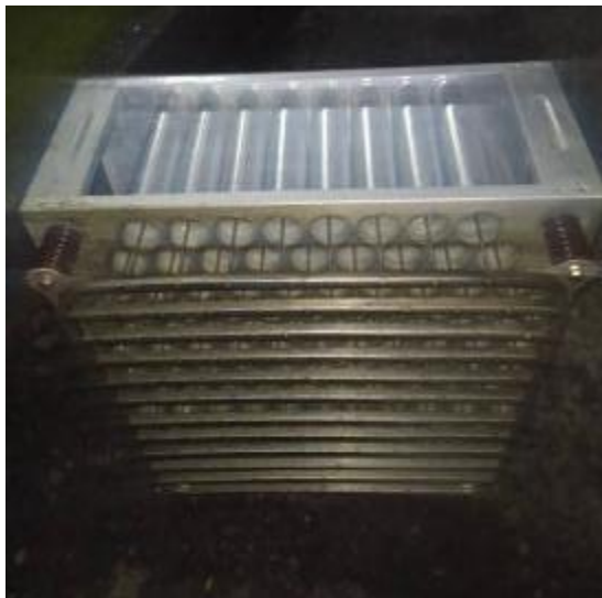
主楼负一楼厨房净化器清洗前
