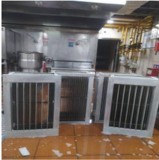
东楼1楼净化器清洗前
