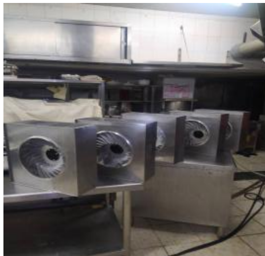
主楼 4 楼厨房风扇清洗后
