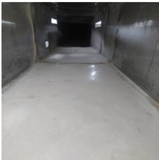
主楼3楼厨房新风管清洗前
