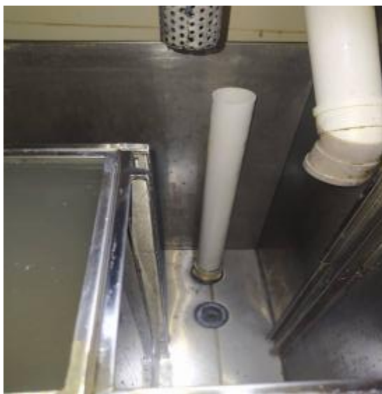
东楼 1 楼运水控制箱清洗后
