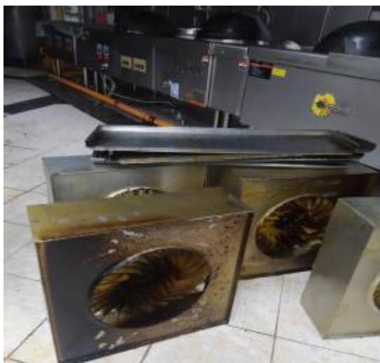
主楼 4 楼厨房风扇清洗前
