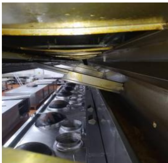
东楼 1 楼烟罩清洗前 1
