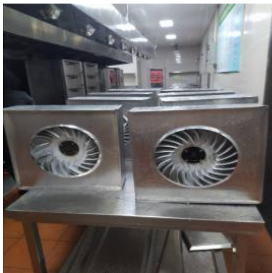
东楼1楼运水风轮清洗后
