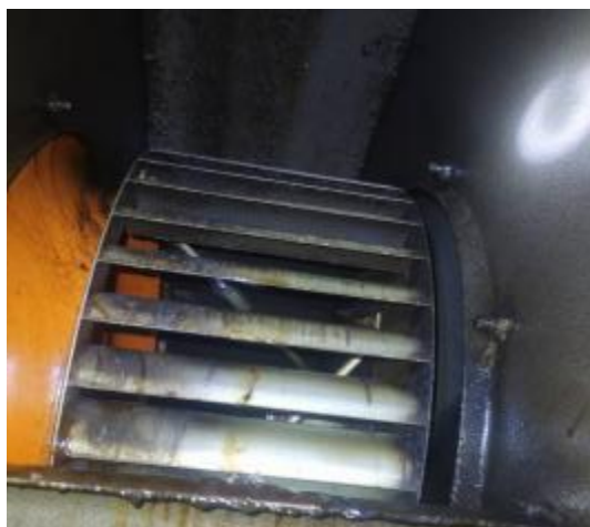
东楼静音风机清洗前
