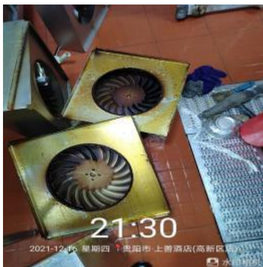
运水风扇清洗前
