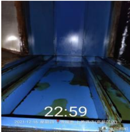
净化器机箱清洗前
