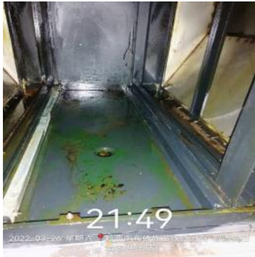
净化器机箱清洗前
