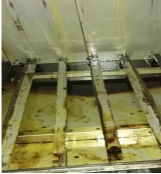
净化器机箱清洗前
