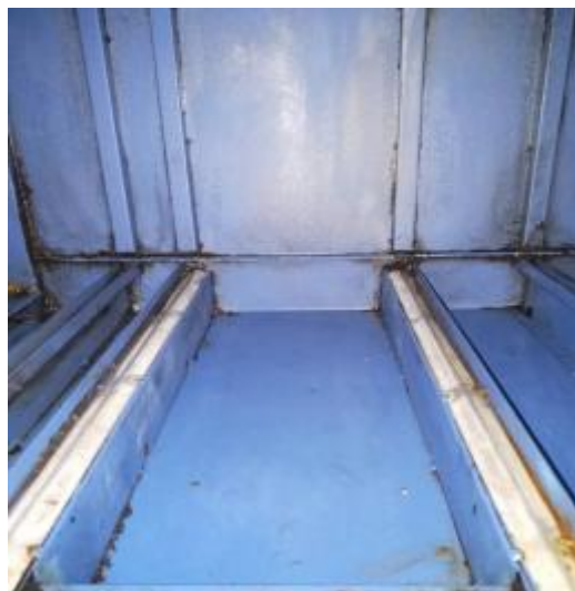
净化器机箱清洗后
