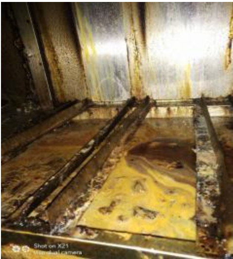
净化器机箱清洗前
