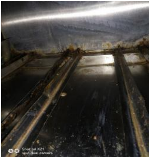
净化器机箱清洗后
