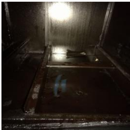
净化器内部清洗前
