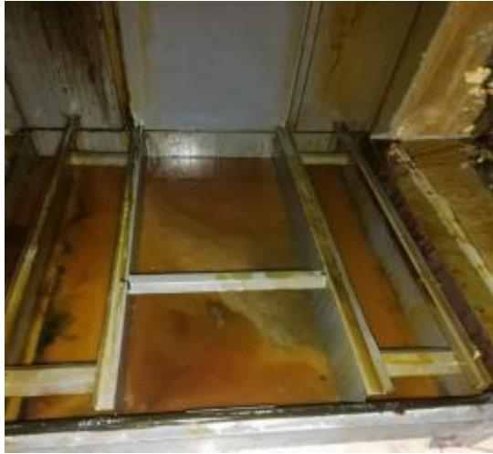
净化器机箱清洗前
